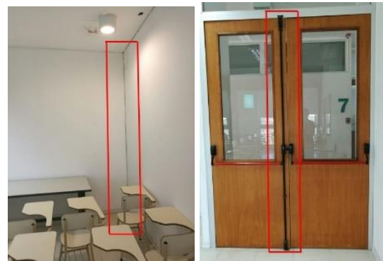
Figura 1: Imagen a la Izquierda: Posible fuga lateral en los tabiques de las distintas aulas. Imagen a la derecha: Posible fuga vertical entre la unión de ambas hojas en las puertas de las distintas aulas.
