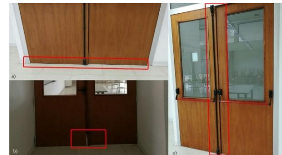
Figura 3: a) Posible fuga debajo de las puertas de las distintas aulas. b) Posible fuga en orificio roto en las puertas. c) Posible fuga en defectos en el mecanismo de cierre de las puertas de las aulas.
