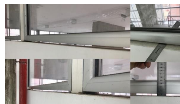
Figura 4: Posible fuga horizontal en las ventanas de las distintas Aulas.
