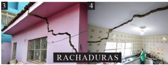
Figura 2: Crateras nas ruas e rachaduras em edifícios causadas pela subsidência de solo, bairro Pinheiro.
